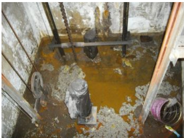
ピット内には、1.4t程滞留水が確認された。
