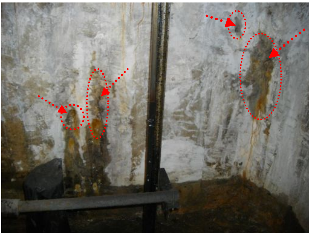
ピット壁躯体の矢印の部位より漏水していた(内部ジャンカと思われる。)
