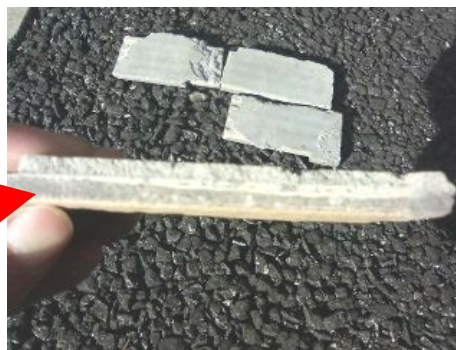
剥離落下した外壁タイルです。
