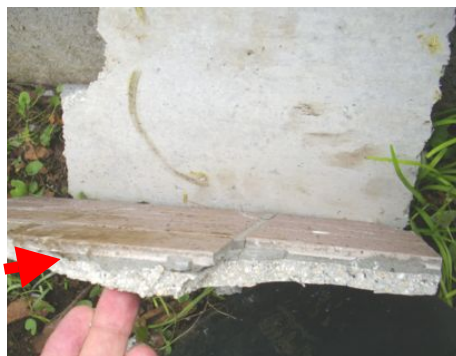
剥離落下した外壁タイルです
