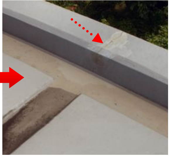
左の梁躯体に続く共用廊下スラブ躯体に連続するクラックと暫定的な直し跡です
